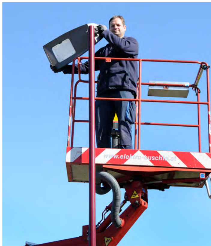
Robert Hrzic, Elektrotechniker bei der Firma Buschta, bei der Montage einer LED-Leuchte auf einer der Straßenlaternen in Höchst.
